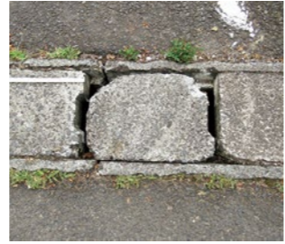
側溝蓋のガタツキ
