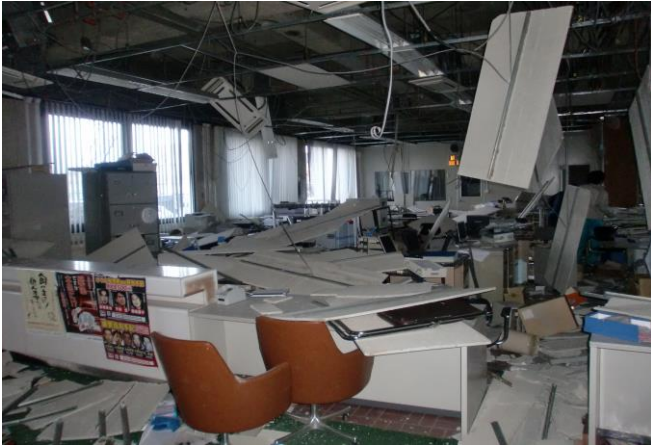
東日本大震災（2011年）で被害を受けた 役場庁舎
