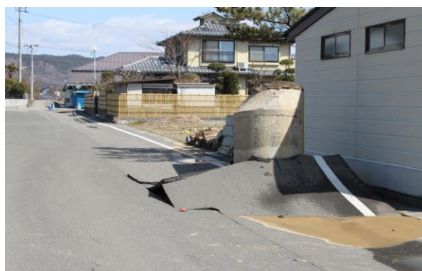
液状化現象により2mほど突き上がったマンホール (平成23年3月東日本大震災)
