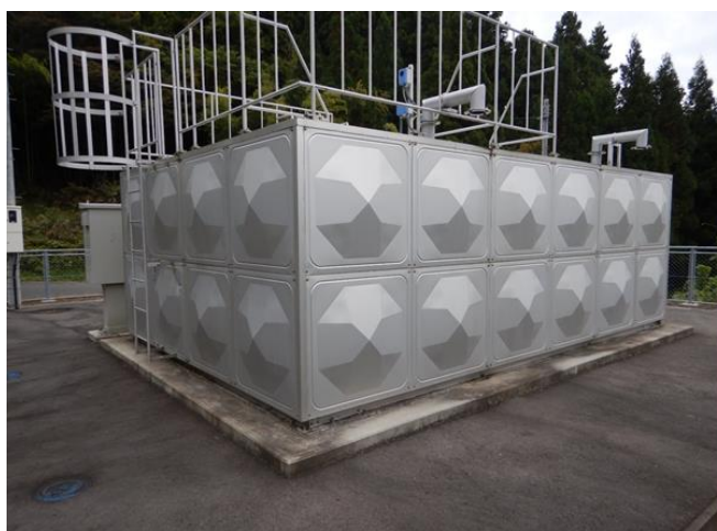
赤坂配水池（平成29年2月完成）
