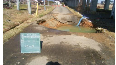
東日本大震災道路陥没（桑折町万正寺地内）
