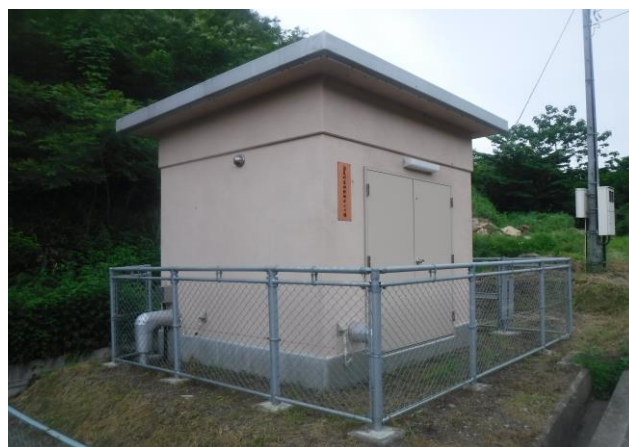
泉田新田ポンプ場（平成29年2月完成）
