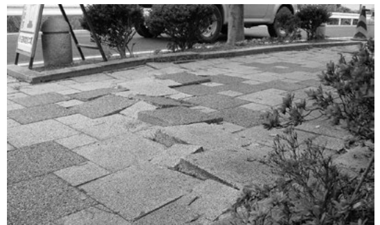
歩道の路面のタイルが剥がれて凹凸に
