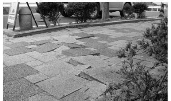
歩道の路面のタイルが剥がれて凹凸に
