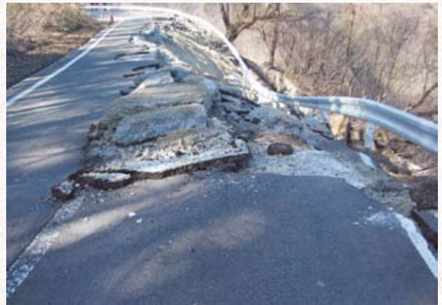
崩落した主要地方道白石国見線、小坂峠。
