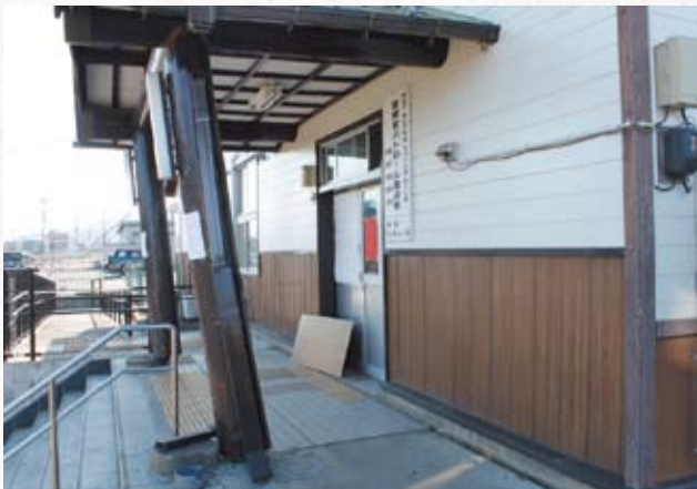
JR 東北本線藤田駅。入口の柱が土台から外れ危険な状態となり立ち入り禁止に。
