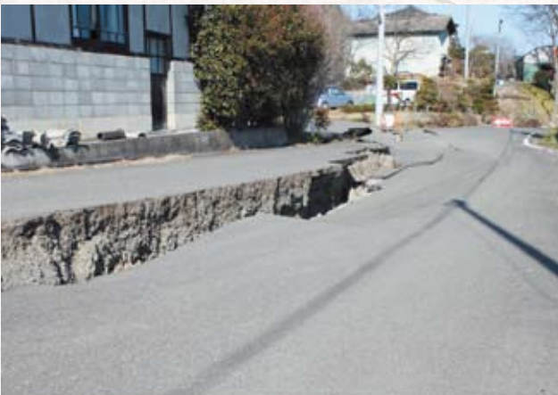
町道9号線、徳江字館ヶ崎地内。通行不能。
