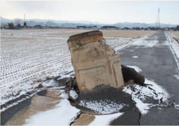
液状化により浮上した下水道マンホール。至る所でこのような現象が見られた。
