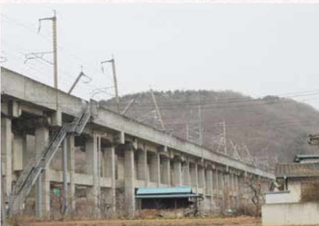
東北新幹線蔵王トンネル出口付近。架線電柱は軒並み傾いた。
