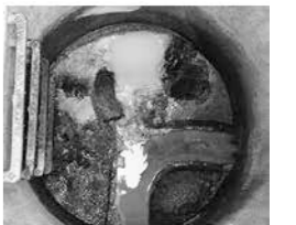
油が詰まったマンホール内部
