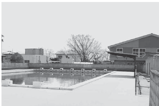
老朽化で本格改修を待つ県北中学校プール
